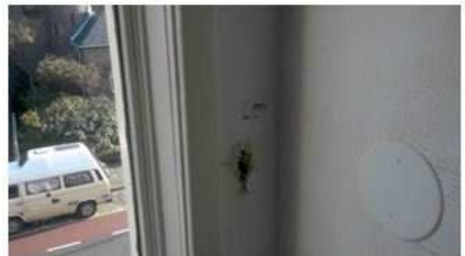
Afbeelding 2: Asbesthoudende lijmlaag achter gevelisolatie
